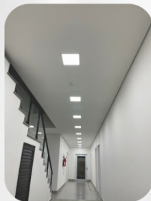
Forro em Drywall
